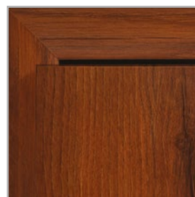
górna krawędź skrzydła bez przyłgi
